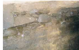
Bröckelnder Verputz Sanierung notwendig.
