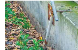
Verrostete Schieber: ersetzen!
