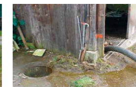
Hier besteht ein erhöhtes Risiko für einen Güllunfall!
