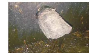
Holzzapfen sind ein Risiko und führen immer wieder zu Lecks. Sanieren!
